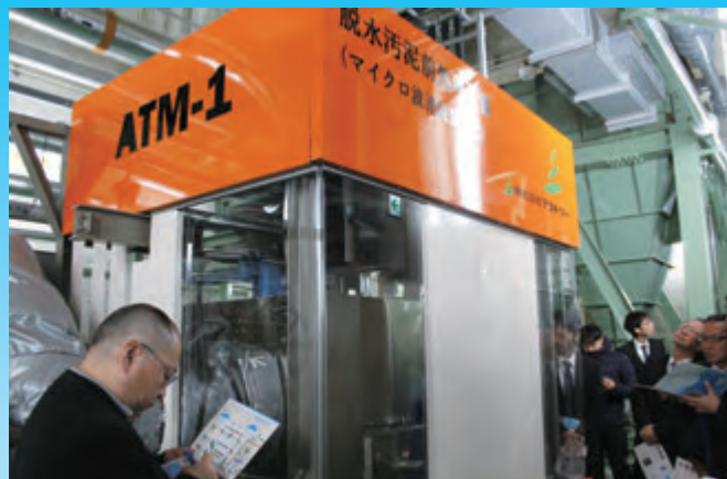
污泥改質設備
