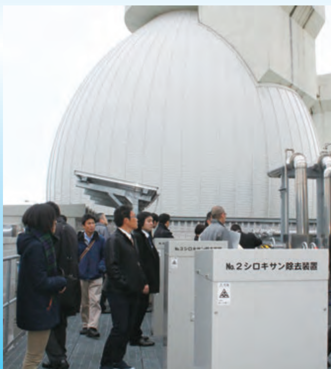
卵形消化槽とガス発電施設
