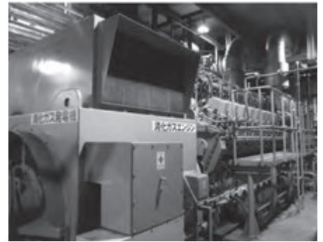
写真3 消化ガス発電機
