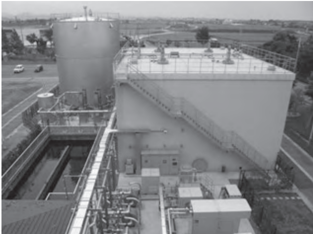
写真-2 メタン発酵槽
