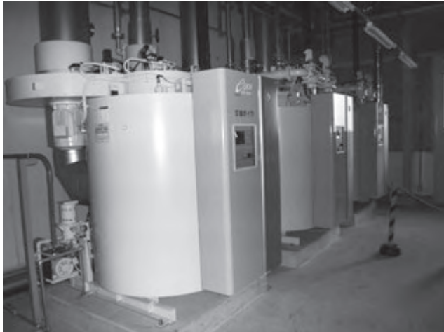
写真-4 バイオマスボイラー
