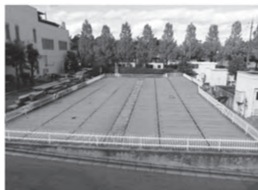
写真1 消毒槽（塩素混和池）
