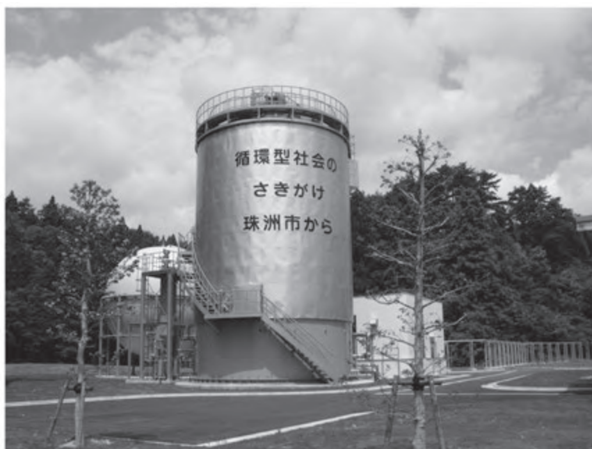
写真-1 「メタン発酵槽」
