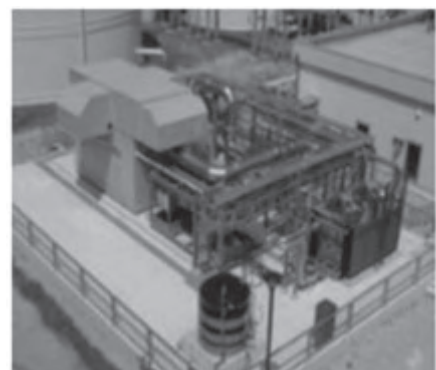
図5 垂水処理場 消化ガス発電設備 (660kW)
