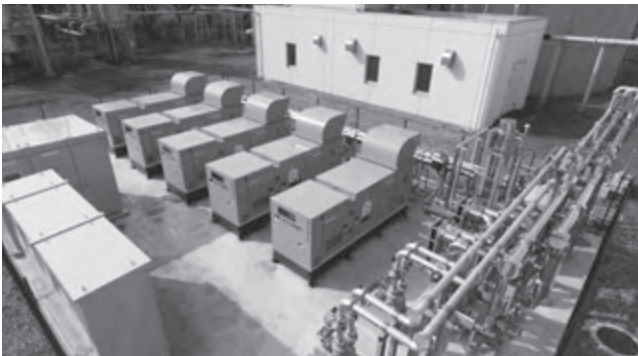
図-3 消化ガス発電設備全景
