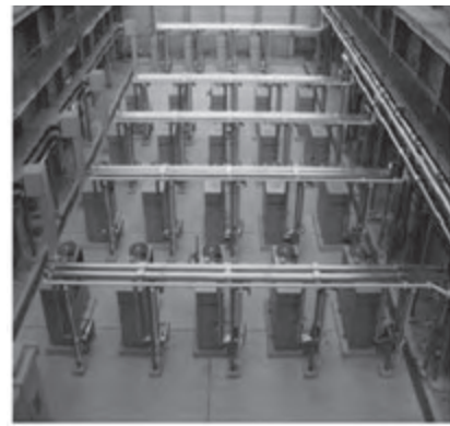
図8 西部処理場 消化ガス発電設備（25kW×24基）
