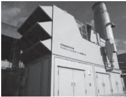
写真4 ガスタービン発電機
