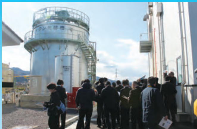
メタン発酵槽
