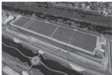
図7 こうべWエコ発電プロジェクト 太陽光発電設備 (2,000kW)
