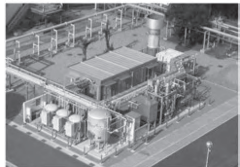
図4 都市ガス導管注入設備
