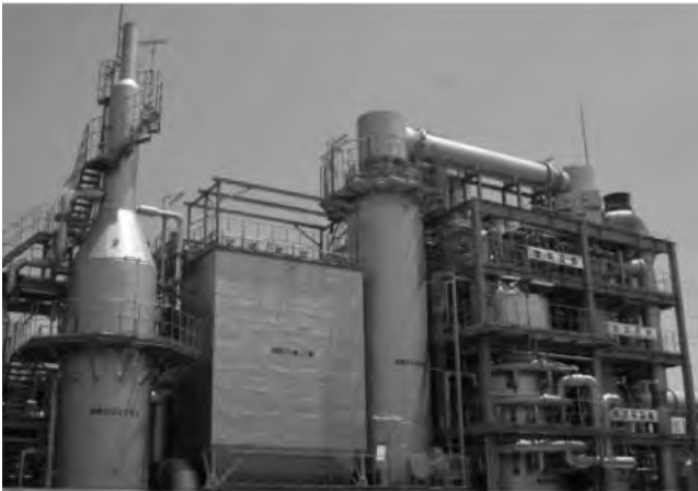
稼働を開始した清瀬水再生センター下水汚泥ガス化炉
