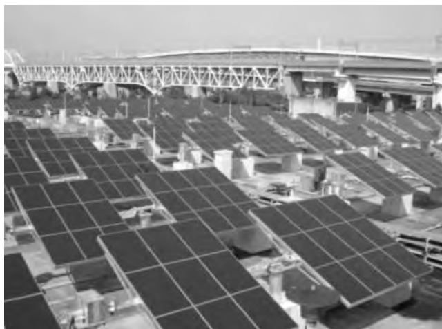
図9 太陽光発電設備（一軸追尾タイプ）
