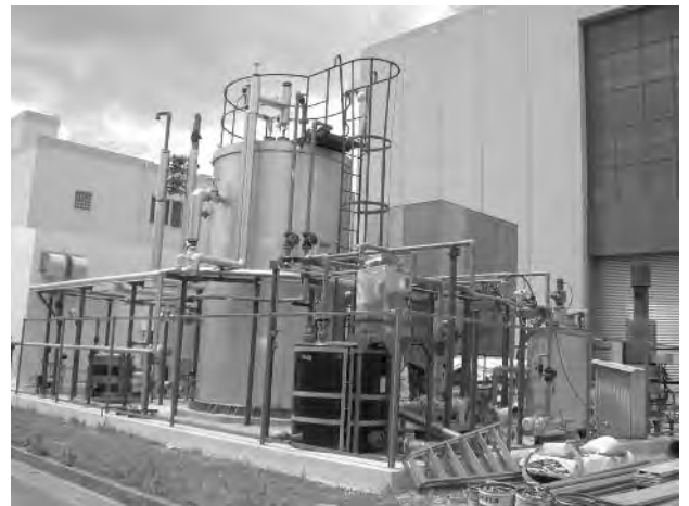
写真2 熱可溶化高効率嫌気性消化の実証プラント （猪名川流域下水道原田処理場）
