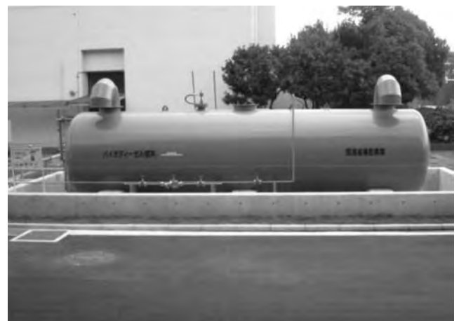
写真－5 BDF燃料専用貯蔵タンク20kℓ
