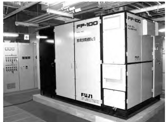
写真-2 既設燃料電池外観
