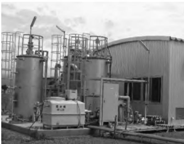
写真3 超高速嫌気性消化の実証プラント （熊本県八代北部流域処理場）
