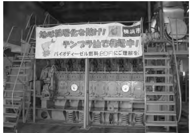
写真－4 BDF燃料で運転中の自家発電設備
