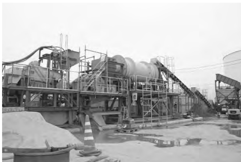
写真ー2 現地洗浄設備
