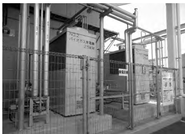
写真3 順調に稼動している国産消化ガス発電システム
