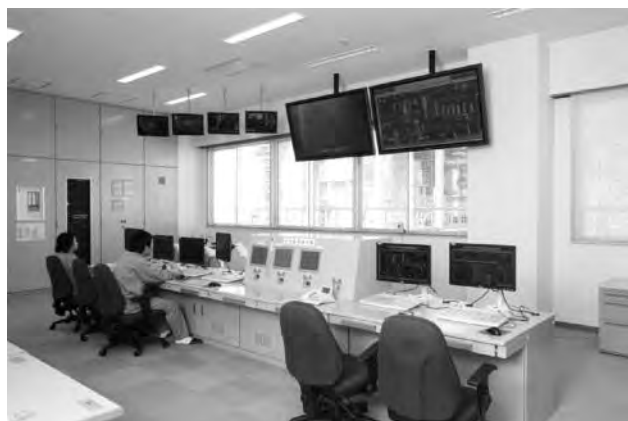
図－4 中央制御室
