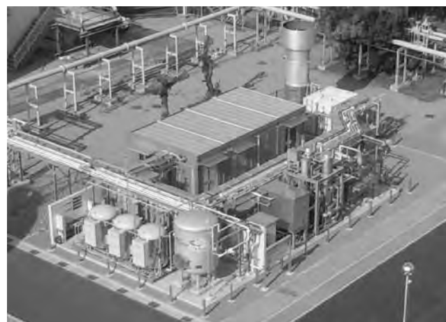
写真-5 バイオガス都市ガス導管注入設備
