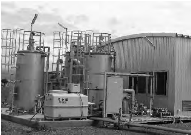
写真3-1 担体充填法実証プラント （熊本県八代北部流域浄化センター）
