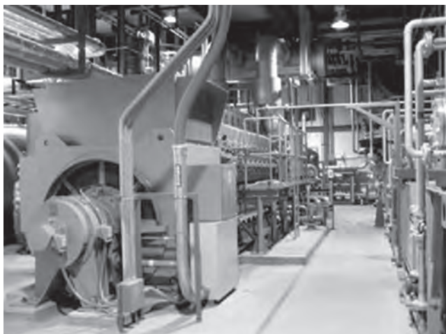
写真1 ガスエンジン発電機
