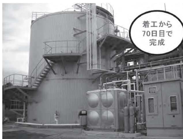
写真5 鋼板製消化タンク (750 m³)
