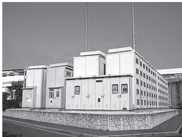
写真2 NaS 電池設備
