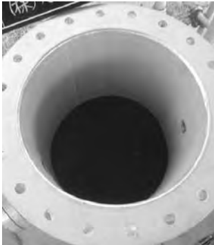
(下) 写真－３ シロキサン除去装置内面 (活性炭投入後)
