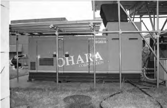
写真－４ BG60 バイオガス発電機 (新津浄化センター)
