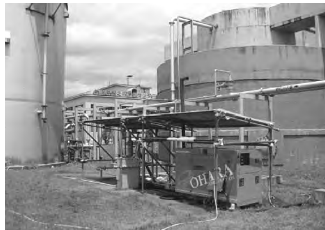
写真－1 実証試験風景（堀之内浄化センター）
