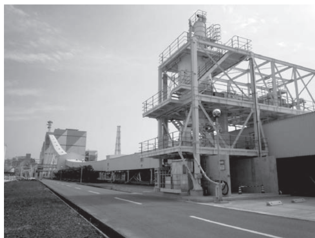
写真５ 炭化燃料受入れサイロ（碧南火力発電所内）
