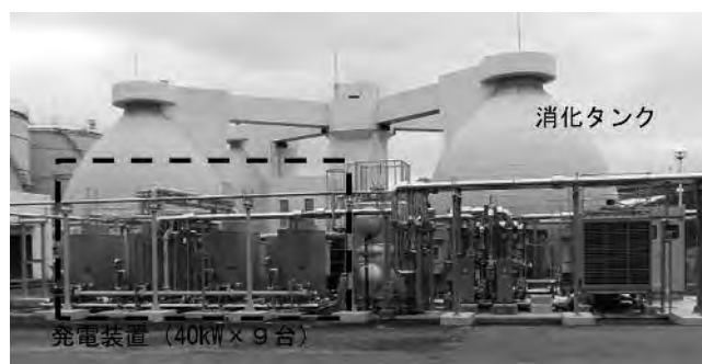
写真1 RE発電システムの外観 （ロータリーエンジン発電装置 40kW×9台、制御盤、現場操作盤、熱交換器他一式）
