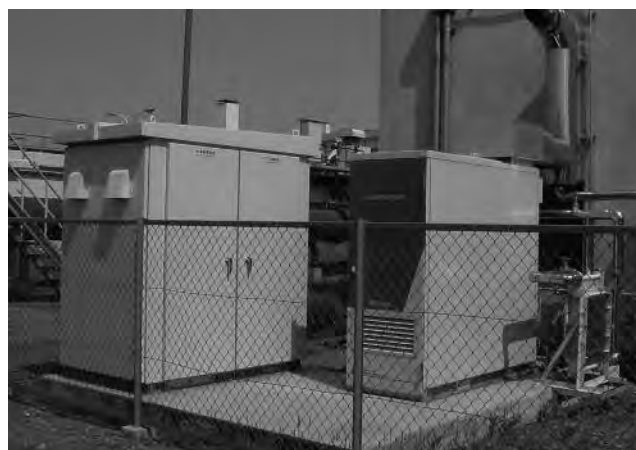
写真-2 バイオマス発電設備 ※旧広域関東圏産業活性化センターより600万円の助成を受けました。
