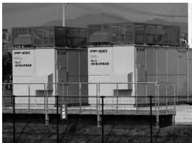
平成25年導入の新型燃料電池（100kW×2基）／屋外に設置
