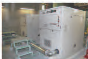
② ガス圧縮機
