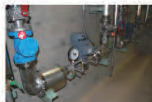
⑤ 温水循環ポンプ
