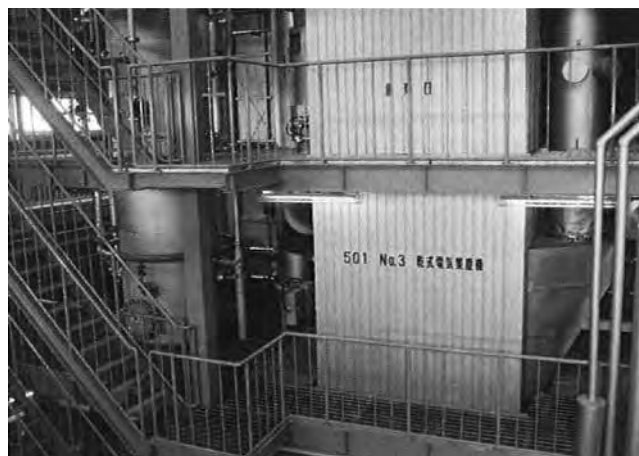
写真6 排ガス処理設備（図7の⑥） 排ガス中のSO x 、NO x 、HCL等の有害物質を洗浄除去し、ダストは帯電させ静電気の力で集塵する。
