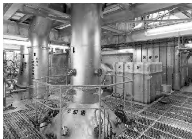
写真-1 焼却・炭化・排ガス処理設備
