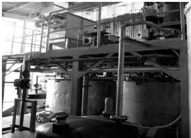
図2 実証ミニプラントの外観（一部） 〔メタウォーター（株）〕
