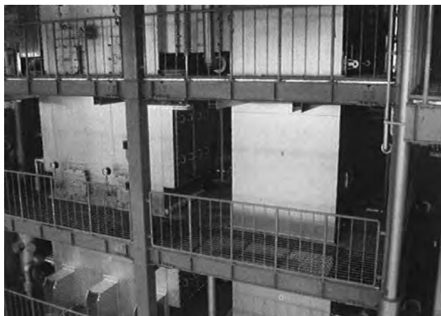
写真5 熱回収設備（図7の⑤） 排ガスから熱エネルギーを回収し、乾燥設備、白煙防止器に有効利用する。
