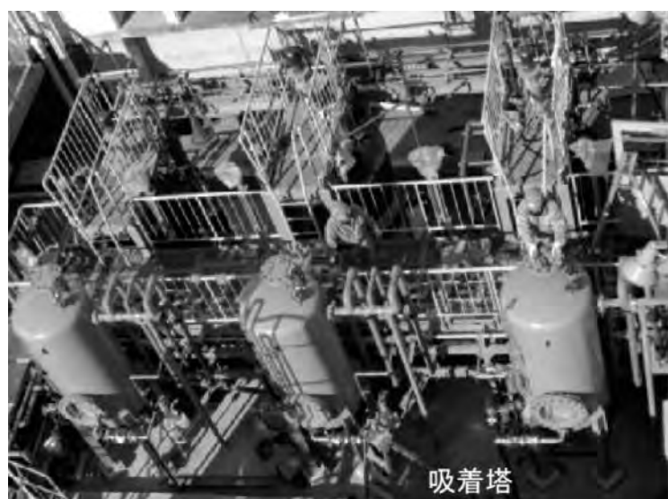
写真 2 実証プラントの外観
