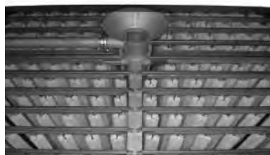
写真3.2 消化タンク内の担体
