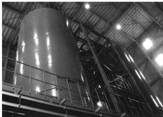
写真1 脱水ケーキ受入設備（図7の①） 脱水処理された汚泥（外部受入汚泥含む）は、ケーキ貯留サイロで一次貯留される。
