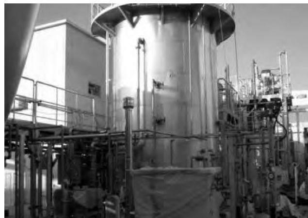
写真3.3 B-DASH実証プラントの消化タンク
