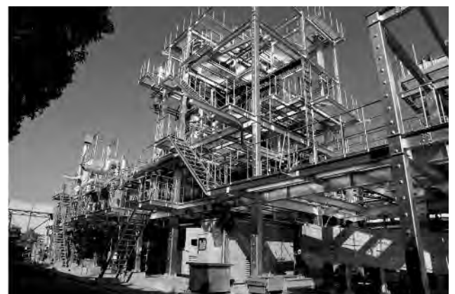
写真1 実証試験プラントの全景
