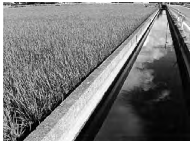
写真ー1 幹線水路を流れる処理水
