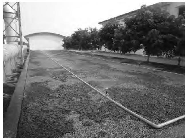
写真5 土壤脱臭施設
