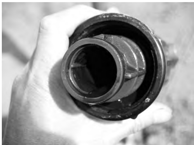
第5図 メタン発酵消化液によるフィルターの詰まり
