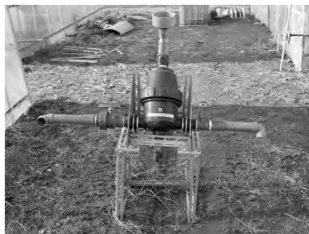
第1図 メタン発酵消化液濾過装置
