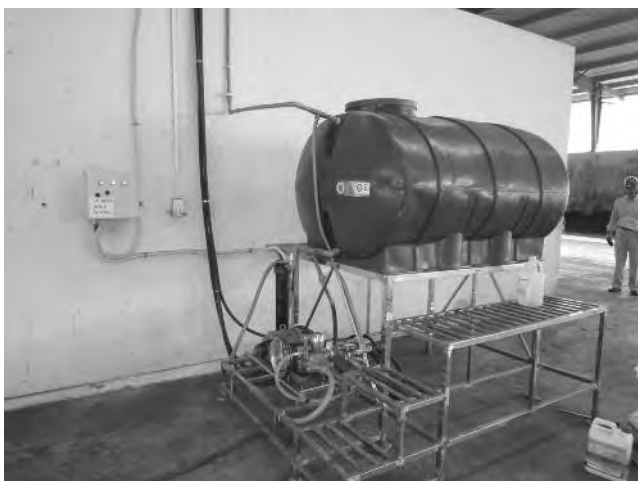
写真4 臭気対策用薬剤添加装置
