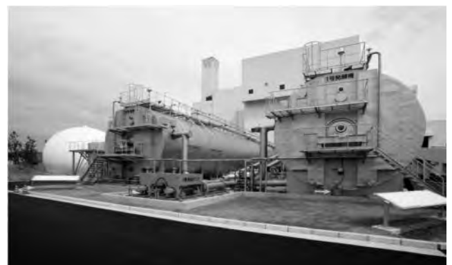
写真 1 バイオガス化施設（メタン発酵槽）
