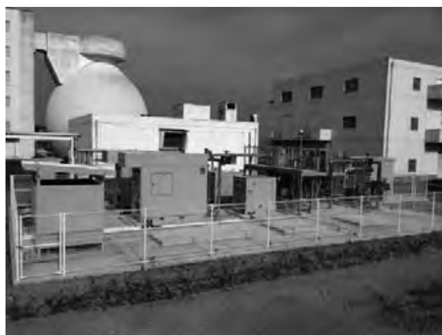
写真-1 南部浄化センターにおける MGT 消化ガス発電設備
