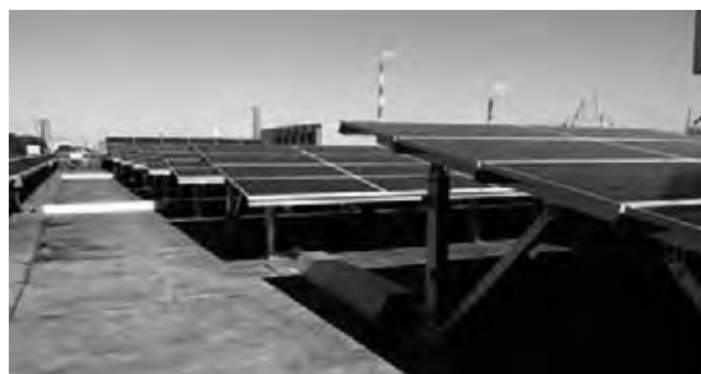
写真-4 北部第二水再生センター太陽光発電設備
