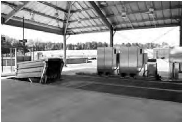
写真-1 米国オーバーン市下水処理場の紫外線消毒装置（1ユニットのみ水路から引き上げた状態）
