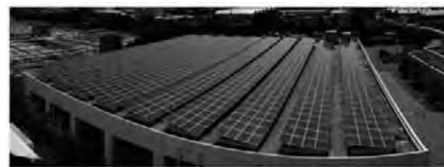
写真-5 神奈川水再生センター太陽光発電設備
