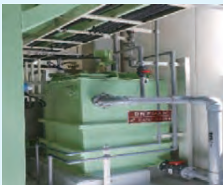
汚泥減容化設備
