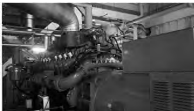
写真 -3 北部汚泥資源化センター消化ガス発電設備
