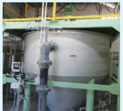
リン回収設備
