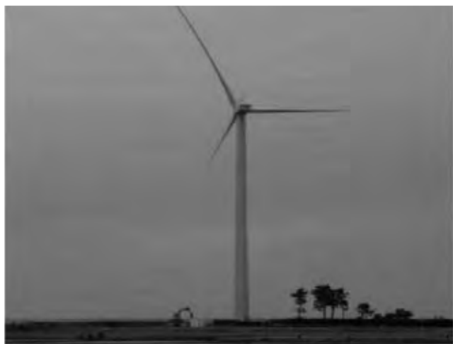
写真 風力発電設備の外観
