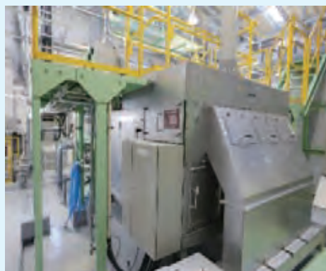
汚泥脱水設備
