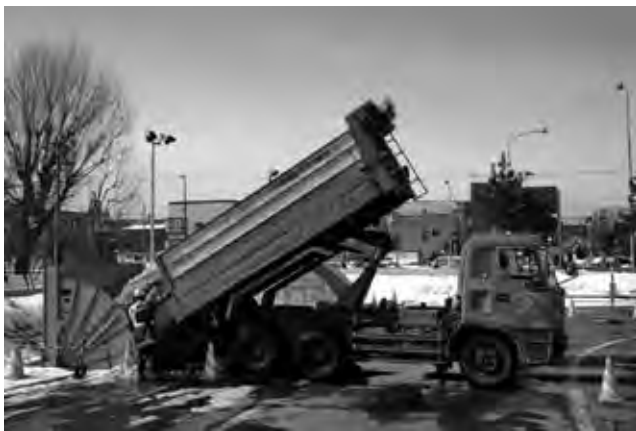
写真－1 融雪管投雪状況
