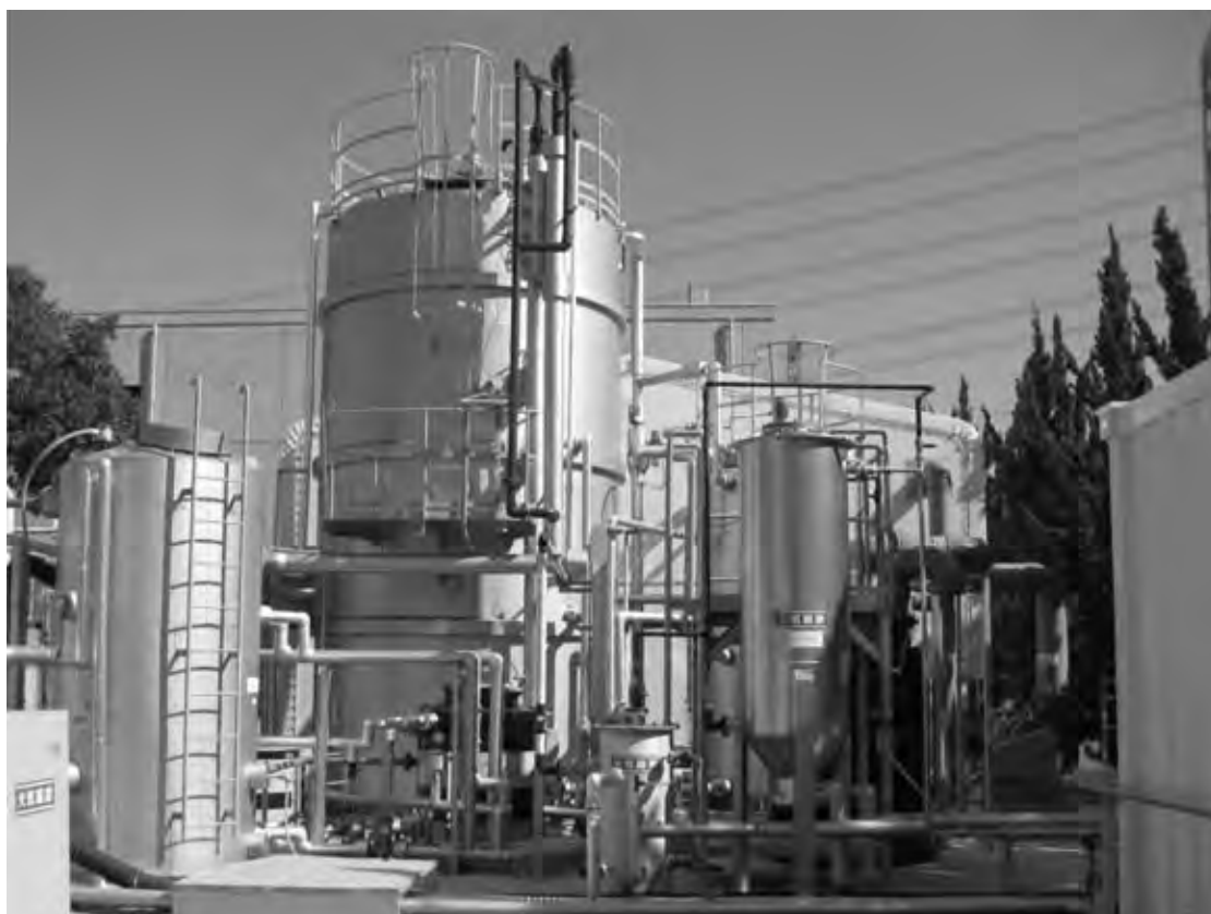
写真1 実証プラント外観
