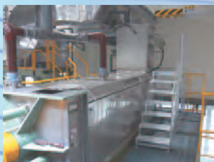
汚泥資源化設備
