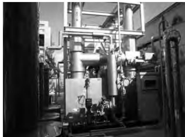
写真6 排ガスボイラユニット
