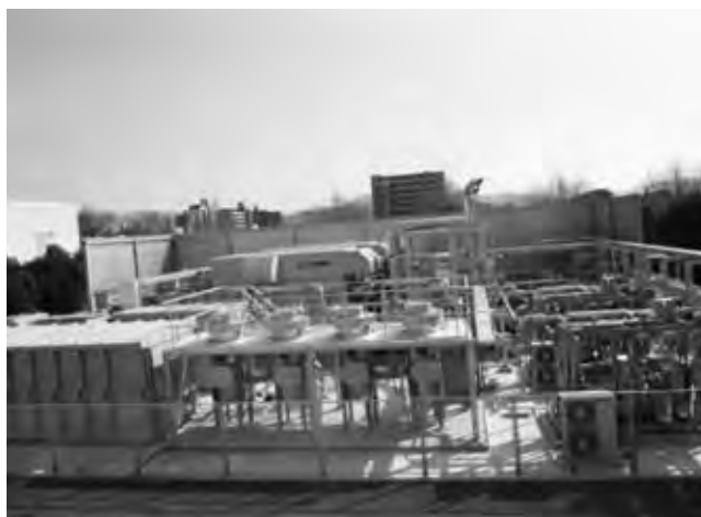
写真3 消化ガス発電設備全景
