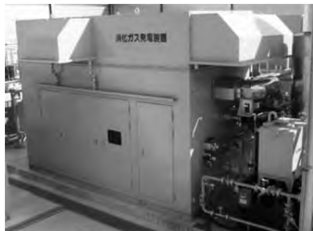
写真4 ガス発電機ユニット
