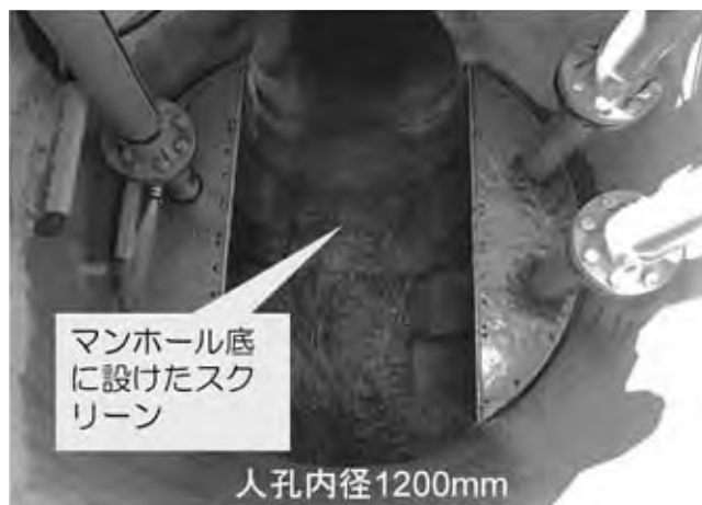
図12 マンホール底部に設けた洗浄機能付きスクリーン(マンホール上部から見下ろした写真、約500世帯の給湯を賄える取水能力。別途に設けた熱交換器で採熱する方式)
