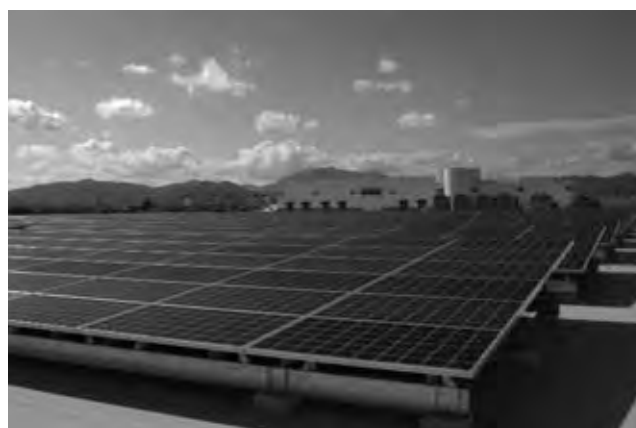
写真 2 モジュール配置状況
