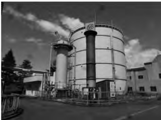
写真－2 都市ガス原料供給施設
