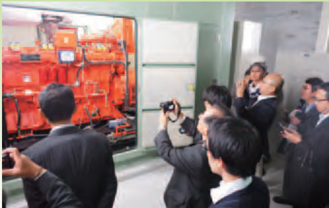
ガスエンジン
