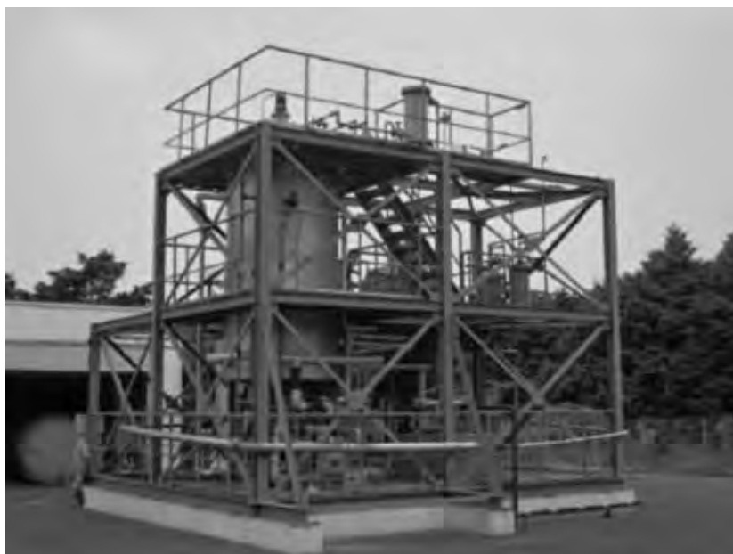
図4 メタン発酵の実証プラント写真
