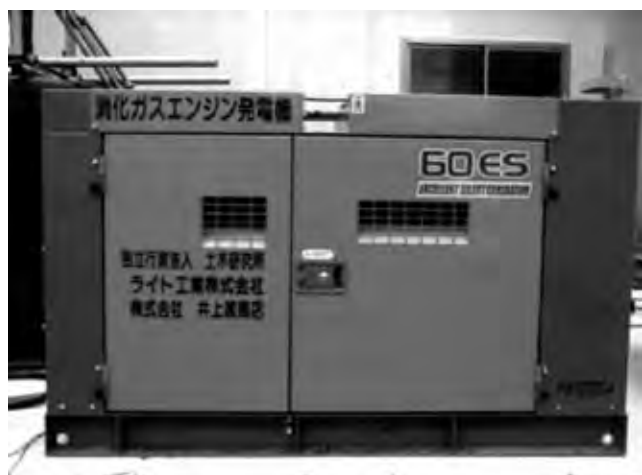
図 10 土木研究所が開発したバイオガス発電機
