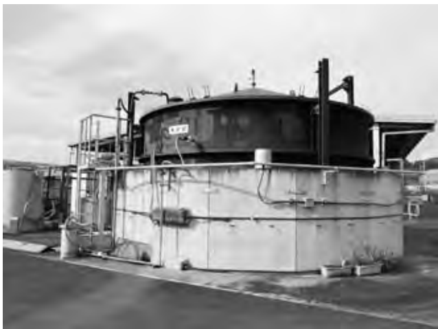
メタン発酵タンク
