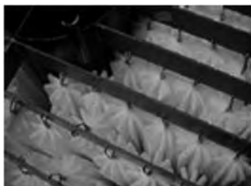
写真 3.1 消化槽内に設置した担体
