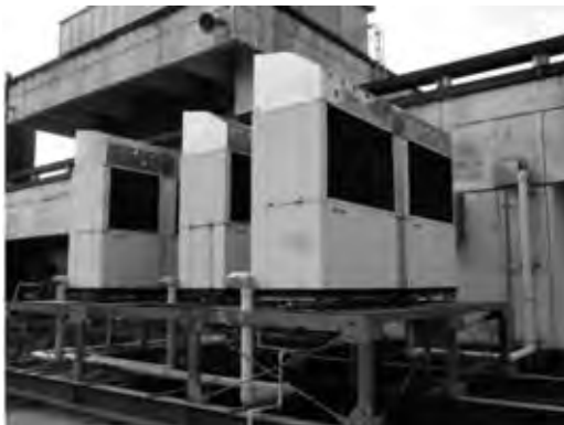
写真－3 都市ガス原料供給施設設備ほか 上：ガス圧送機 中：ガス冷却器 下：冷暖房設備室外機
