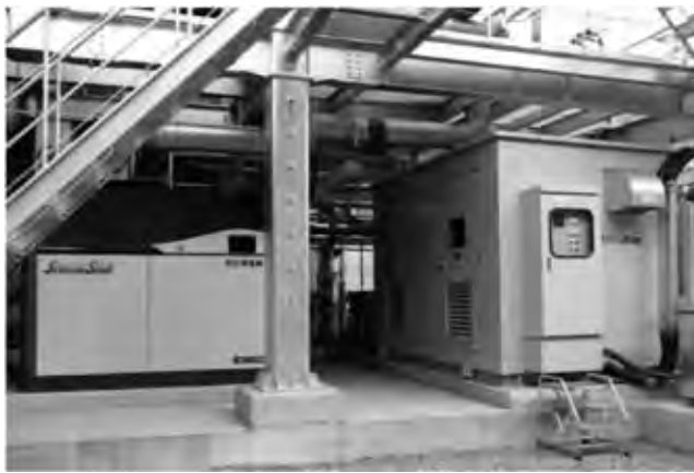
写真 3.3 小型蒸気発電機（左）とバイナリ発電機（右）
