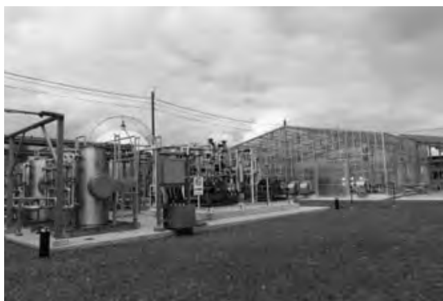
写真-1 CO 2 回収・藻類培養実証施設の全景
