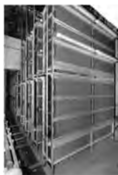
写真－1 膜ユニット
