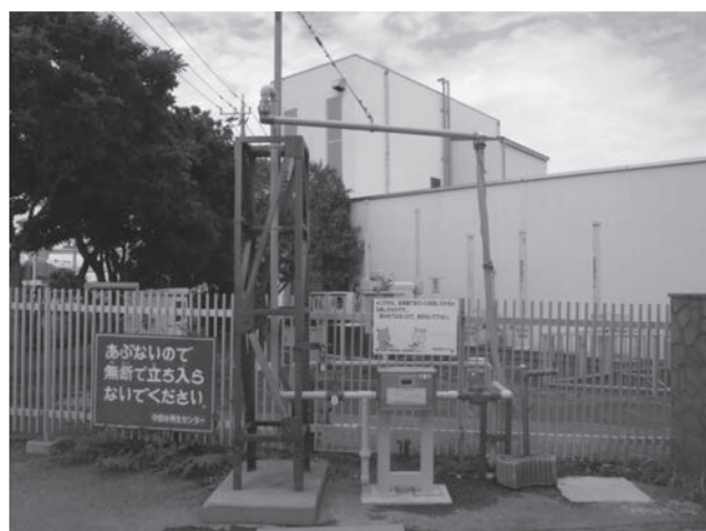
写真 1 再生水供給装置
