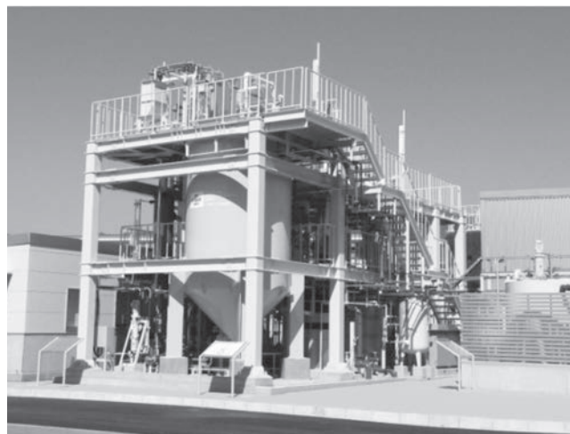
写真1 リン再生実証設備
