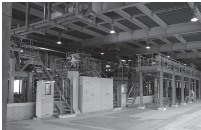
写真1 リン回収施設全景
