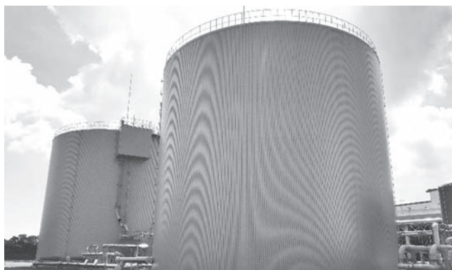
写真-3 場内に設置された2基のメタン発酵槽
