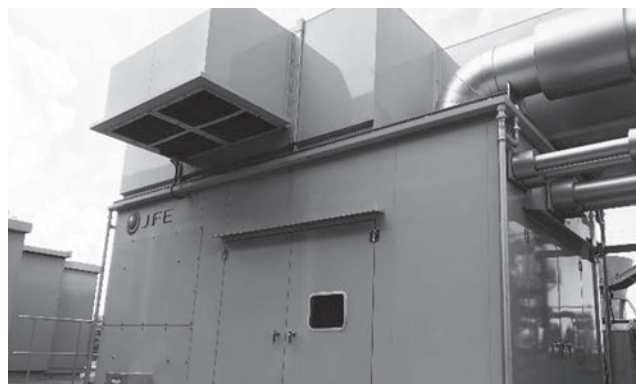
写真-4 ガス発電設備の外観
