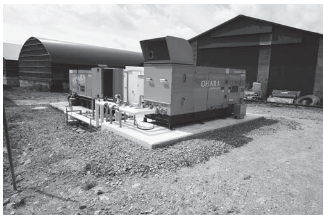
写真1 2台(50kW, 100kW)のバイオガス発電機
